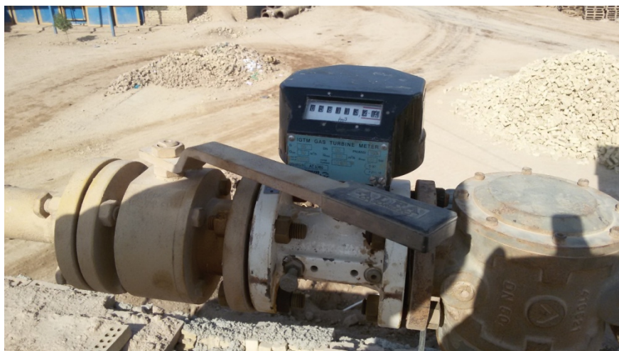
شکل ۲-۳: کنتور ۲ اینچ نصب شده بر روی ورودی گاز اصلی به یکی از کوره کارخانه آجرسازی شیرین
