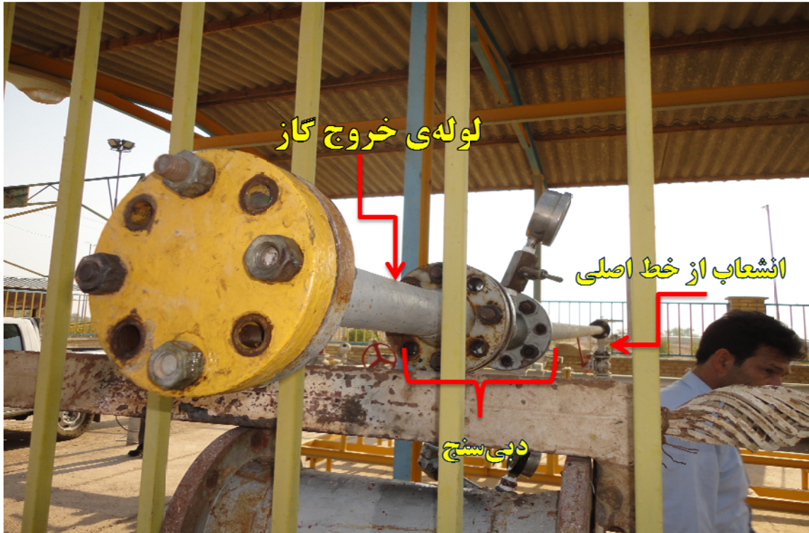
شکل ۱۸-۲: تجهیزات نصب شده جهت نرم‌افزار تخمین میزان هدر رفت گاز
