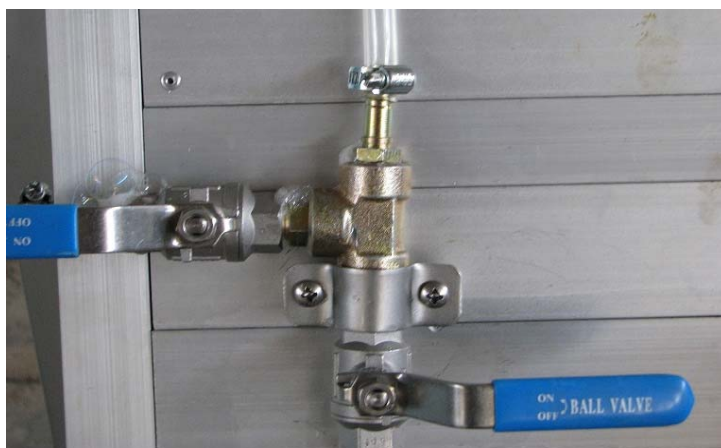
شکل ۲-۴۸: نشستی در اتصالات شیرها
