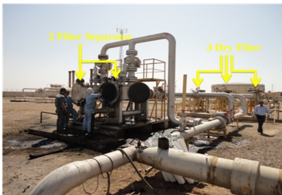
شکل ۱-۴: ایستگاه تقلیل فشار نیروگاه آبادان
