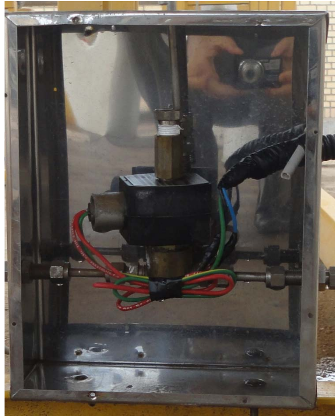
شکل ۷-۲۹: شیر برقی استفاده‌شده در طرح
