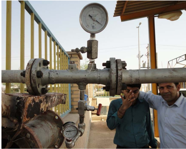
شکل ۲-۱۹: تجهیزات نصب شده جهت نرم‌افزار تخمین میزان هدر رفت گاز
