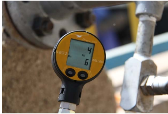
شکل ۲-۱۴: فشارسنج نصب شده برخط اصلی
